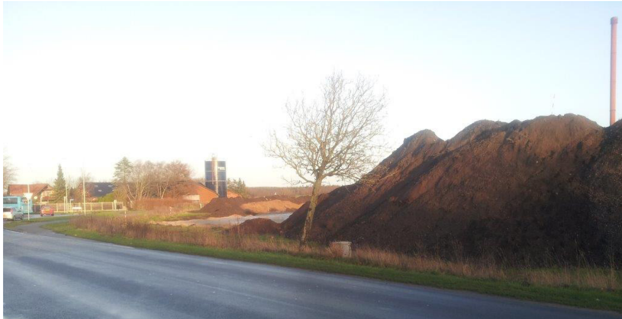
Anlægsarbejder i forbindelse med udvidelse af Scanflavour er i fuld gang, og store bakker af overskudsjord præger arealerne mod vest ved ankomsten til Møldrup fra nord.
