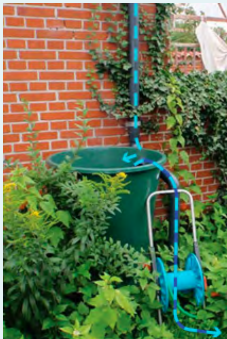
Tagvandet ledes via nedløbsrøret til regnvandstønden. Når tønden er fuld, ledes vandet i overløb til et andet ned-sivningselement i haven. Tønder fås i flere varianter, og kan som i dette tilfælde skjules af beplantning. Foto Orbicon.
